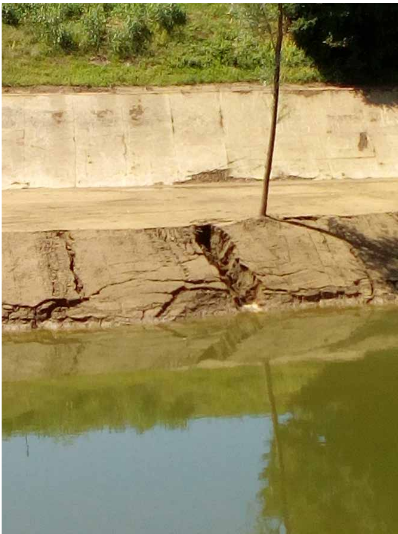
15 maggio 2017, fiume Arno, Firenze, a valle della Pescaia dell'Isolotto Foto di Daniela Burrini Iniziati i lavori di risagomatura degli argini, con evidenti segni di erosione
