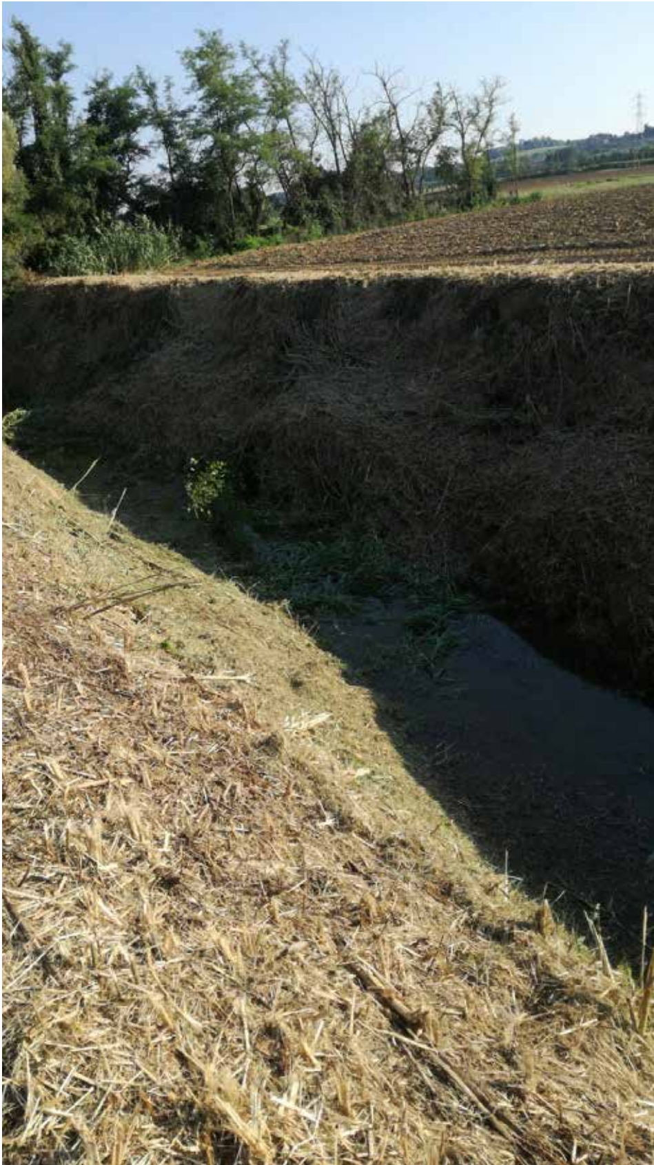
8 agosto 2018, fiume Isola, Crespina-Lorenzana (PI) Foto di Elena Sofia Gabbani Lavori condotti in condizioni di sicurezza precaria
