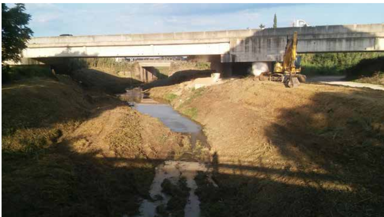
15 giugno 2018, fossa di Bolgheri, Castagneto Carducci (LI), dopo il passaggio dei trinciatutto, a valle ed a monte della vecchia Aurelia Foto di Paolo Maria Politi
